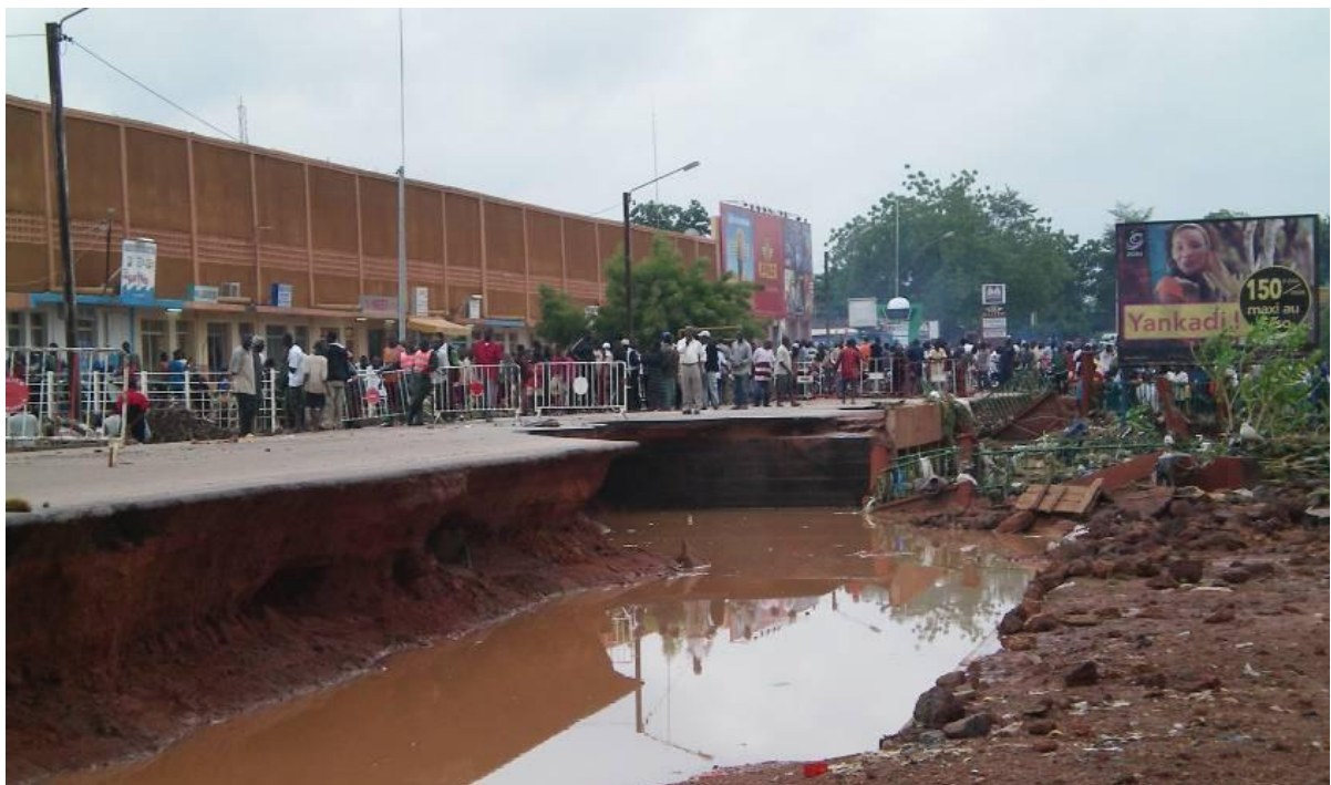
Figure 10: Une route endommagée après les inondations
