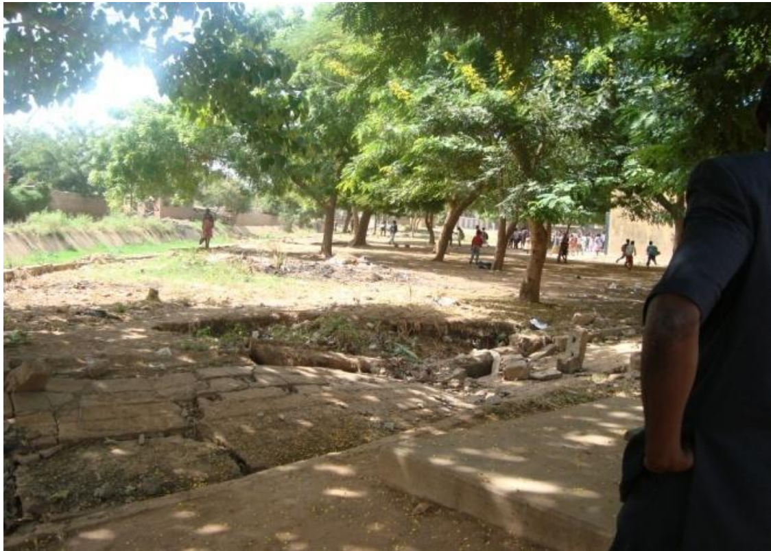
Figure 9: Le mur d'un établissement scolaire écroulé
