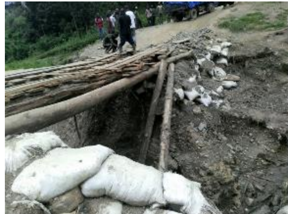
Photo 8 : Etablissement d'un pont de fortune en bois consécutive à l'érosion à Nyabibwe
