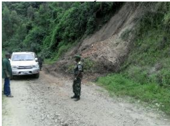
Photo 3 : Eboulement à Nyabibwe
