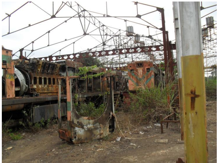
Photo N°16 : Vue des déchets de ferraille au niveau de la gare de la gare de Makabana sur la ligne ex COMILOG
